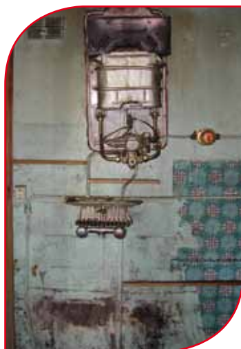
Installation sanitaire dans un logement insalubre © ARS
